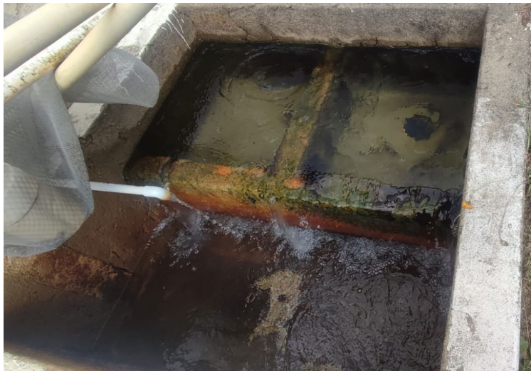
Cámara de salida filtro lento en arena
