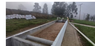
Filtros Gruesos Ascendentes (FGAs)
