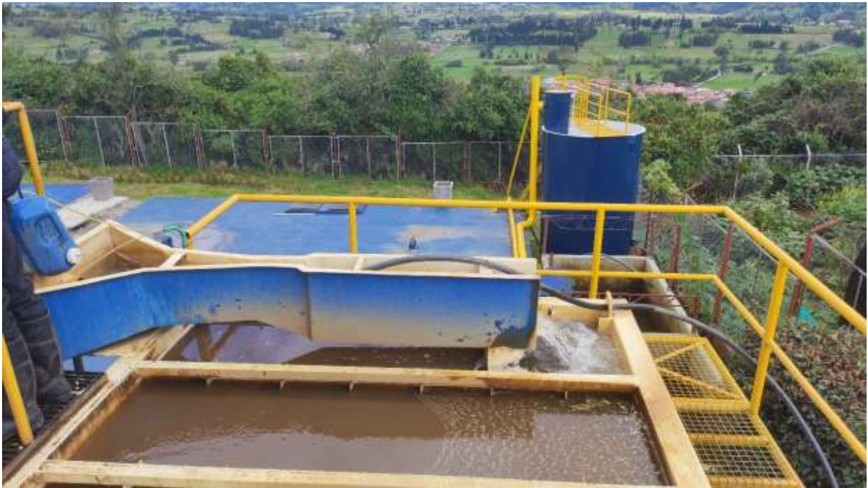
Canaleta Parshall PTAP Ginua
