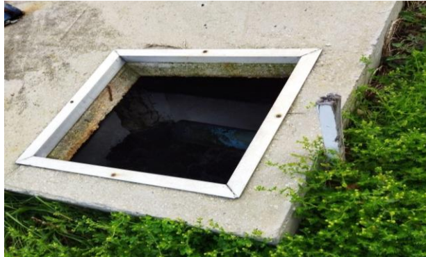
Cámara de llegada y alivio del sistema de tratamiento
