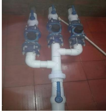
Figura 15. Sistema de macromedición caudal de ingreso a la PTAP Acueducto Teatinos, Fuente: Asociación de Suscriptores del Acueducto Teatinos, 2022.
