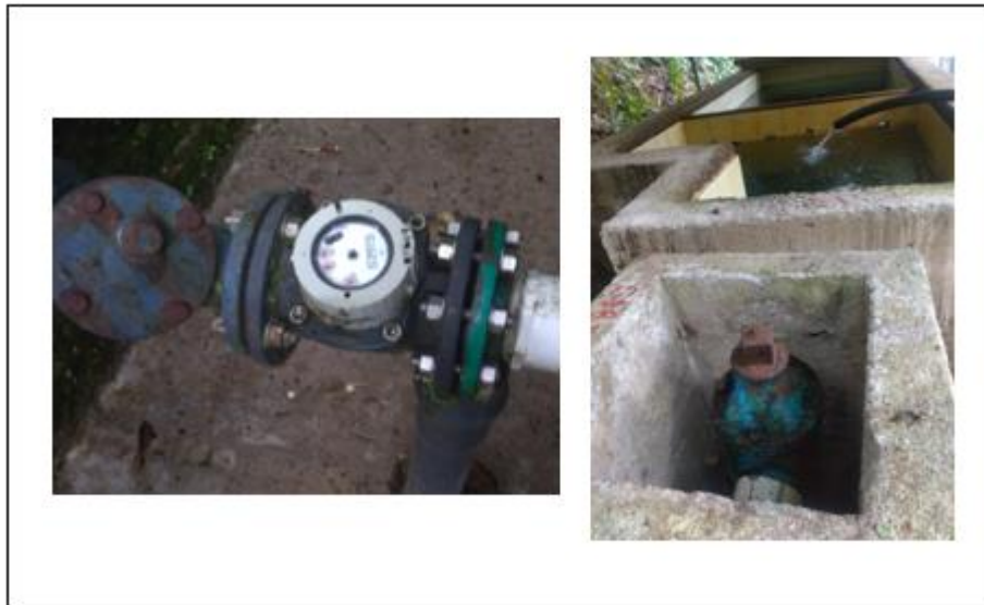
Figura 11. Macromedidor y válvula de compuerta PTAP Pajarito Boyacá, fuente: autor.
