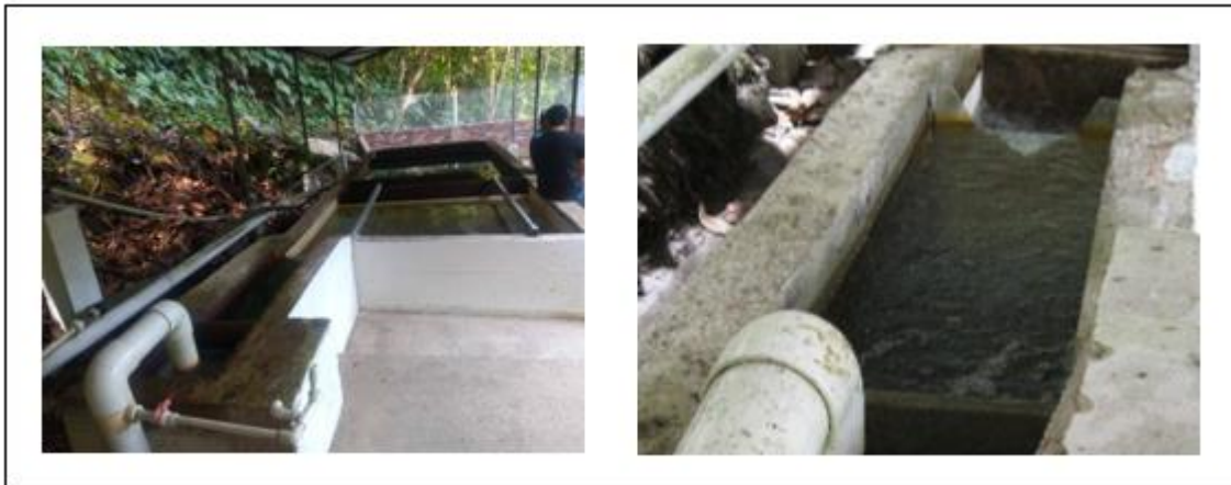
Figura 12. Estructura para mezcla rápida PTAP Pajarito Boyacá, fuente: autor.
