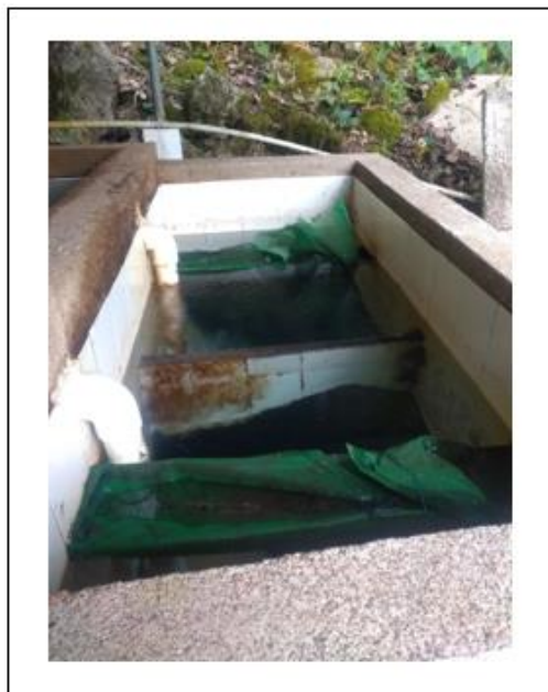
Figura 15. Estructura sistema de filtración PTAP Pajarito Boyacá, fuente: autor.
